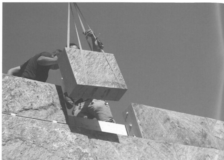
24. Oktober 2011: Hier wird nach über neun Wochen Arbeitszeit auf der Baustelle Bad Schinz nach der Schlussstein gesetzt.
